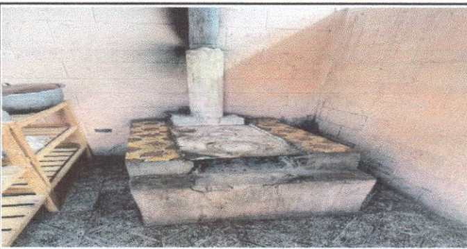
Foto 5: sustitucion de plancha de tres hornillas.
